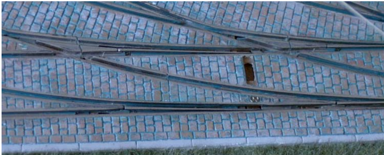
Einfahrt zum Betriebshof – solche Weichen kann man nur selbst bauen, hier nach der Methode "zwei Profile nebeneinander"
